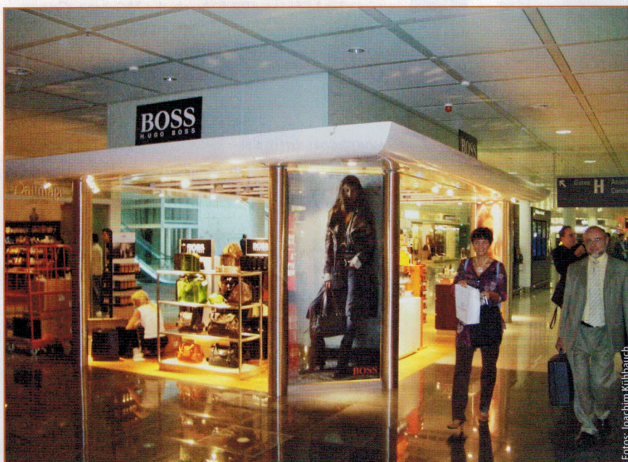
Abb. 1: Unsichtbarer Rauchschutz: textil-flexible Rauchschürzen für einen Eventshop im Flughafen
